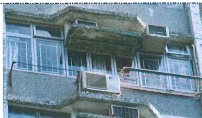
× 將冷氣機組件安裝於不當位置
